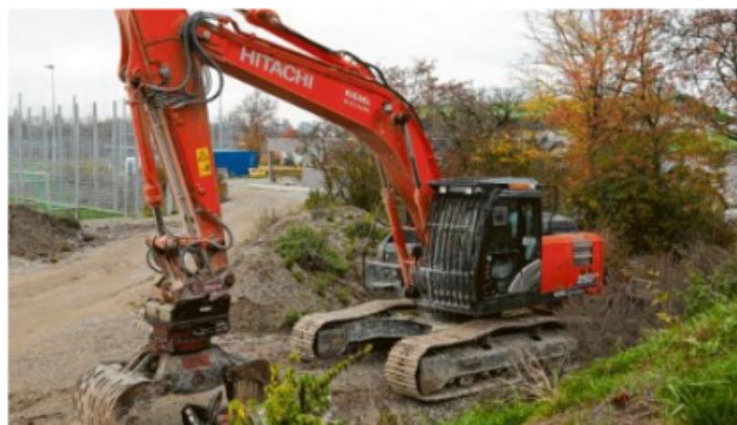
Die Bagger sind auf dem Gelände des TSV 1871 Augsburg bereits aufgefahren und haben mit dem Abriss der alten Räume begonnen. Foto: Michael Hochgemuth
